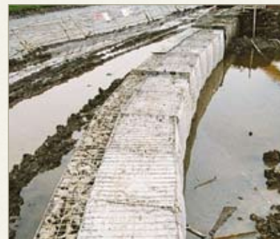
Ar betona pildījumu pildītais barjers pret plūdiem, Collier iela, Skotijā. Uzcelta 2001.gadā.
